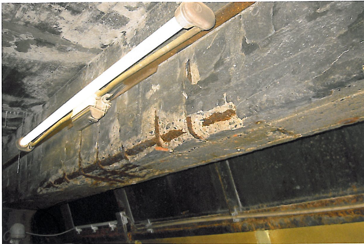
Abb. 1: Behebung solcher und ähnlicher Schäden – Nacht für Nacht im Untergrund
