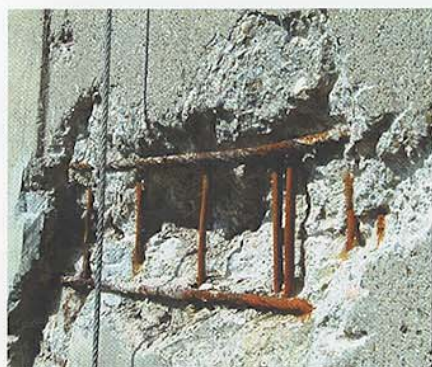
Sanierungsbedürftig: Die frei liegenden Armierungen wurden gestrahlt und konserviert.
