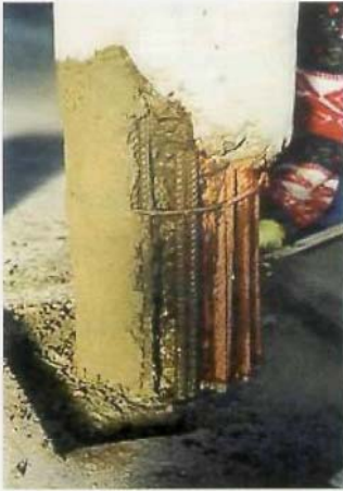
Bild 3. Instand zu setzende Stütze
