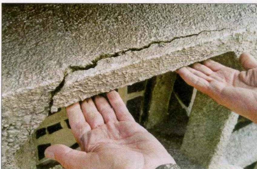
Abplatzungen durch Bewehrungskorrosion.
