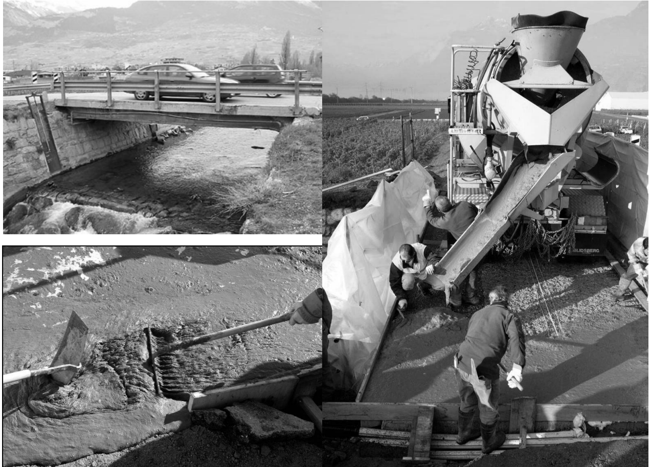
Bild 6: Hoch faserhaltiger UHPC der ETH Lausanne (Prof. Brühwiler) beim Aufbringen auf eine Brücke in der Schweiz. Fotos: ETH Lausanne [3].
