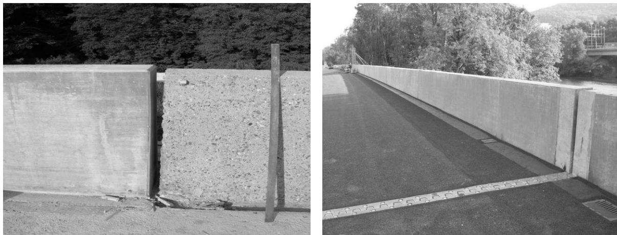
Bild 9: Schutz einer Brücken-Leiteinrichtung durch eine 3 cm dicke Schicht aus einem speziellen UHPC (Fotos: ETH Lausanne).
