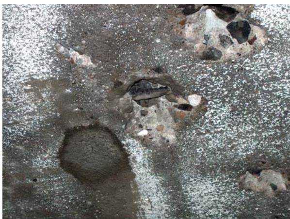
Abbildung 4: Absprengungen („pop-outs“) sowie Gelaustritt durch AZR in einer Fahrgasse
