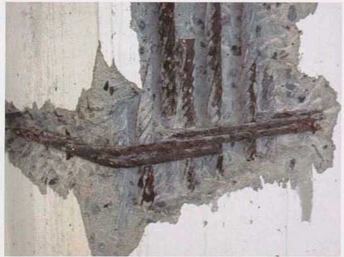
Bild 3. Um den tatsächlichen Istzustand festzustellen, müssen sämtliche Schäden methodisch erfaßt werden
