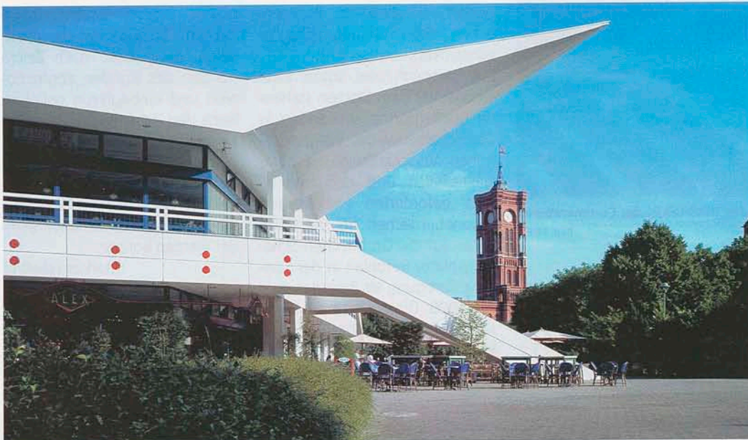
Betonbauwerke müssen geschützt, erhalten und, wenn nötig, fachgerecht in Stand gesetzt werden.
