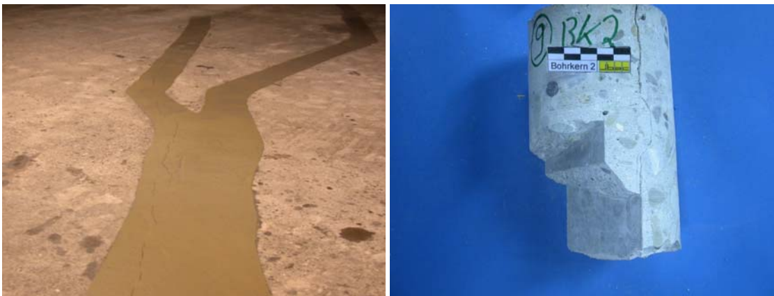
Bild 1: Behandelte Trennriss mit erneuter Öffnung des Risses (links) und typischer Bohrkern in einem Trennriss mit glatter Abschaltung der Arbeitsfuge
