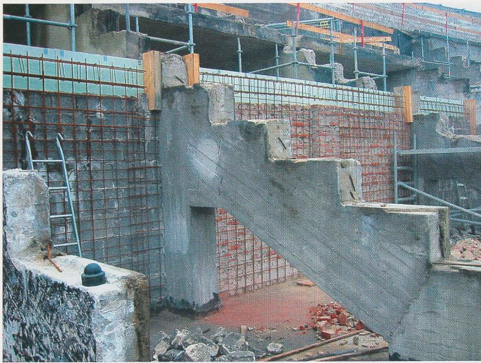
Olympiastadion Berlin: Bestehende, nicht mehr standfeste Wandscheiben aus Mauerwerk oder Stahlbeton werden im Rahmen einer Betoninstandsetzung durch bewehrte Spritzbetonschalen verstärkt.
