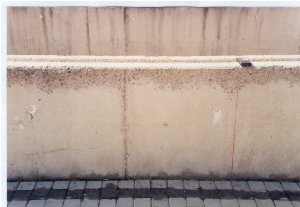
Abbildung 1: Ansicht der Räumlerlaufbahn mit Frost-Tausalz-Schaden
