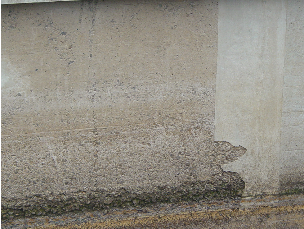
Abbildung 2: Darstellung einer geschädigten Wasser-Wechsel-Zone
